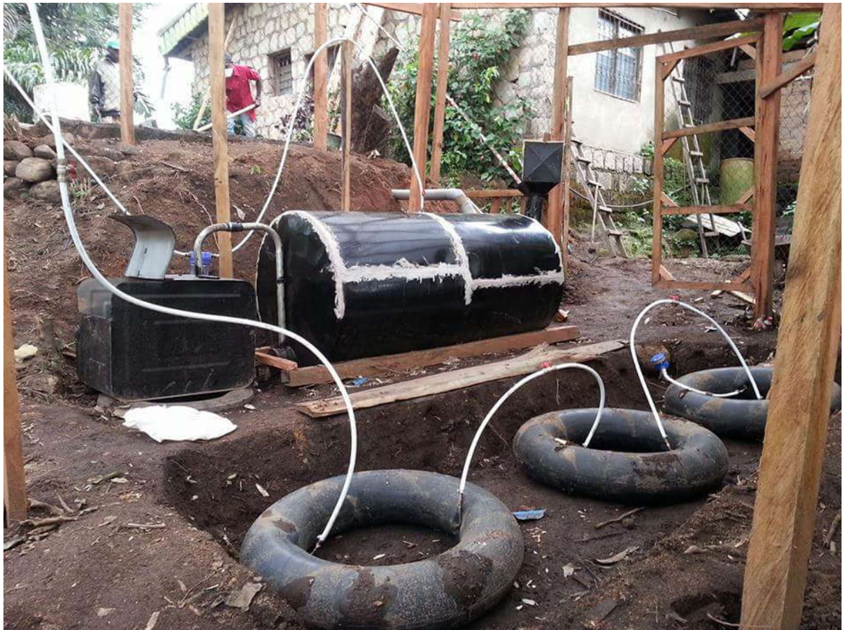
Image 2 : Dispositif de biogaz installé chez un particulier a batoufan
